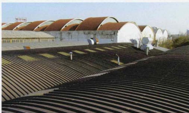
COPERTURE I capannoni della Carrozzeria La Moderna prima e dopo la realizzazione dell'impianto
