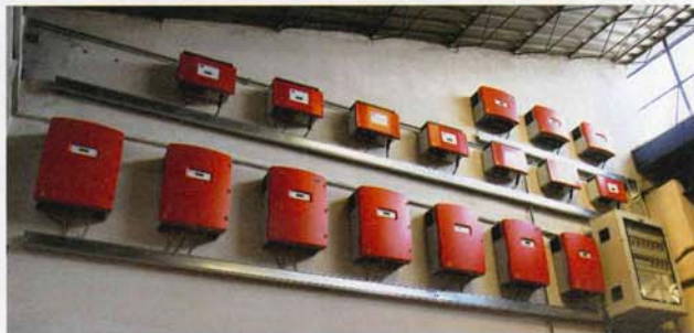
SCHEMA La soluzione d'impianto si è rivelata vincente anche grazie al sistema di 17 inverter SMA
